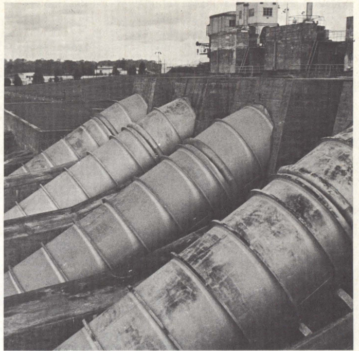
Les conduites d'eau géantes du barrage d'Edéa (Cameroun).
