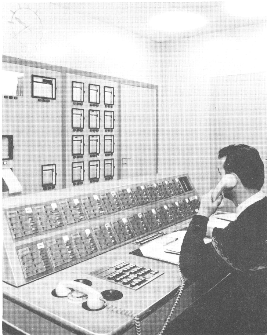
Figure 31 : Exemple de dispositifs d'enregistrement concernant le fonctionnement des machines du fond et appelés «télévigiles»
