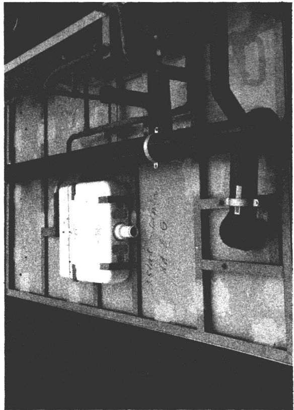
HEESSEN – Cloison technique de la salle de bains
