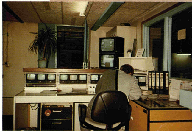
Système de sécurité au parking de la station de métro Slinge
