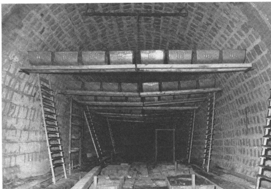
Fig. 20 : Arrêt-barrage à eau et claies à poussières de charbon
