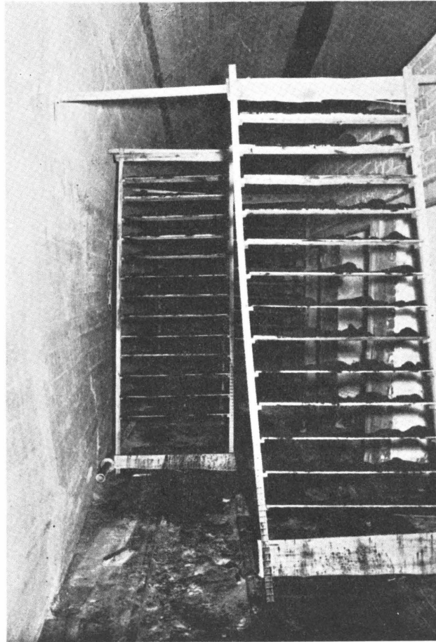
Fig. 19 : Claies à poussières de charbon dans la salle des transformateurs
