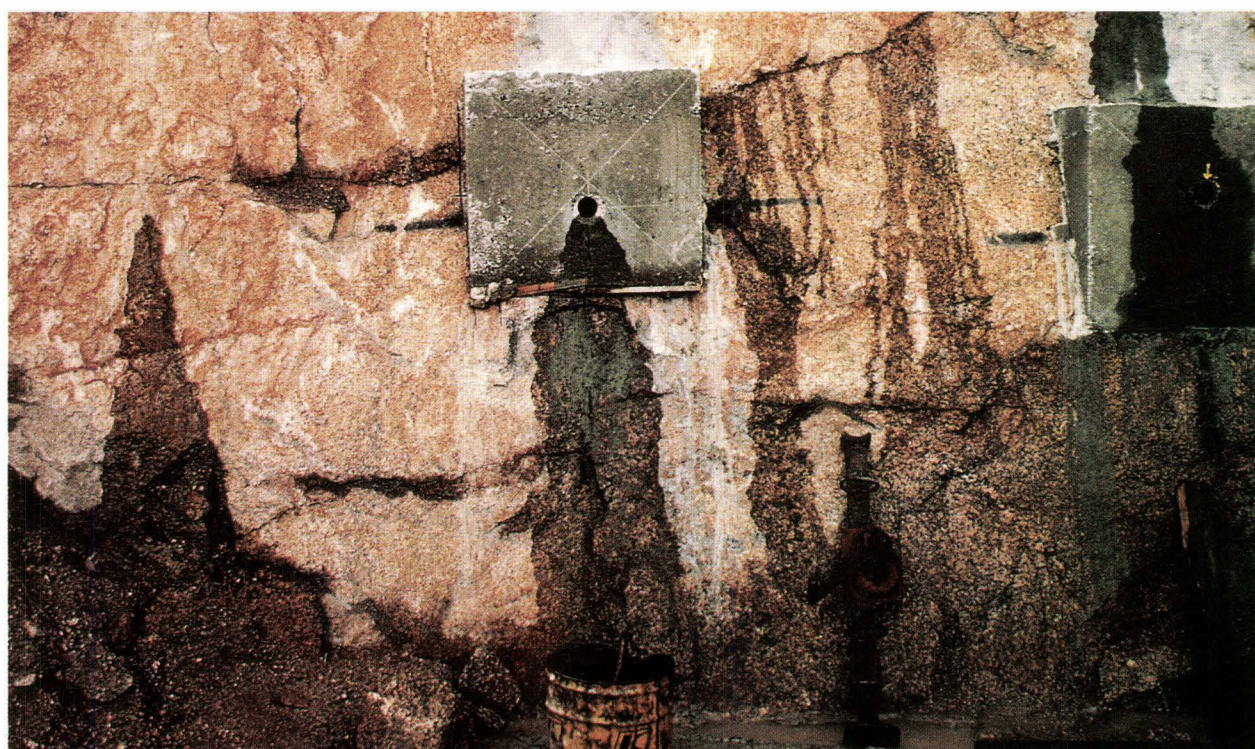
Figure 127 - Circulation d'eau le long des plans pendant la réalisation des forages en diamètre 56 mm. L'exemple montre plusieurs sorties d'eau autour du forage F1
