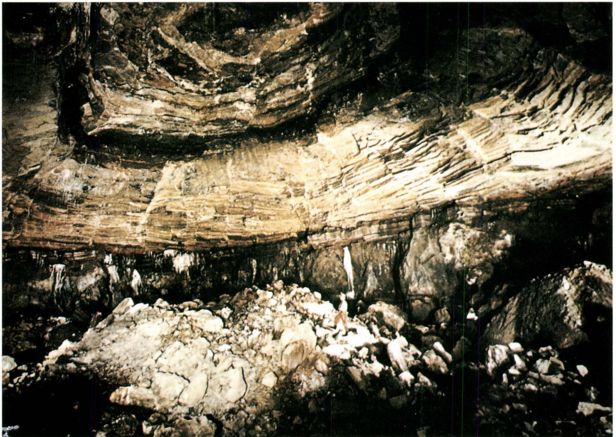
Figure 2 - Ecaillage en galeries de mine
